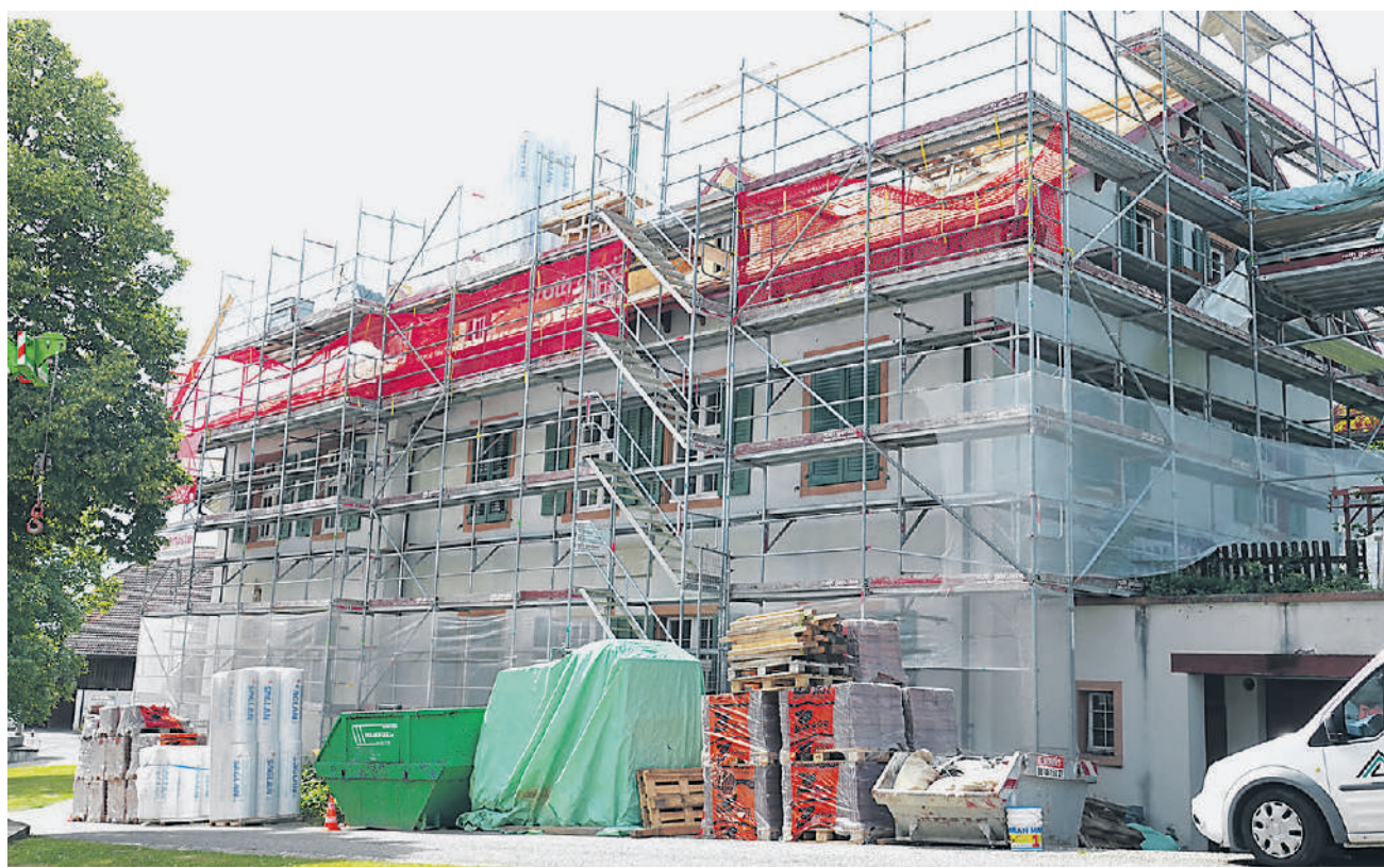
Die Umbauarbeiten haben im Februar begonnen und sollten im Herbst abgeschlossen werden können. Fotos: Valentin Zumsteg
